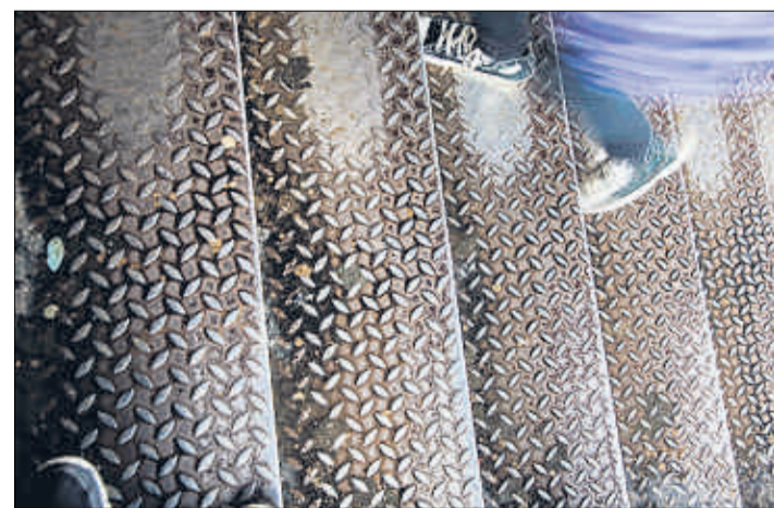
Abgetretene Treppenstufen auf dem Eiffelturm. (Foto: Raabe)
